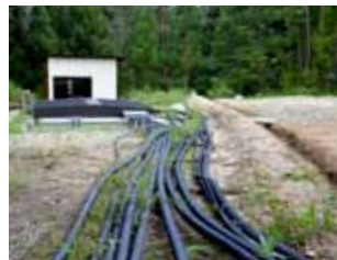
処理水の送水管
