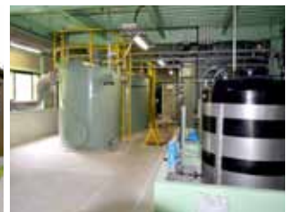
中和処理設備
