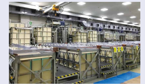
半導体用スパッタリングターゲットの設備、電解槽(磯原工場)
