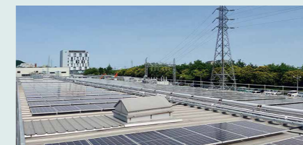
磯原工場屋上に設置した太陽光発電設備
