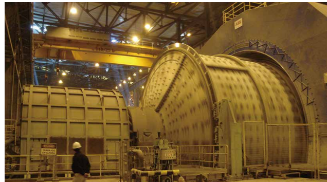
カセロネス銅鉱山の鉱石処理プラント
